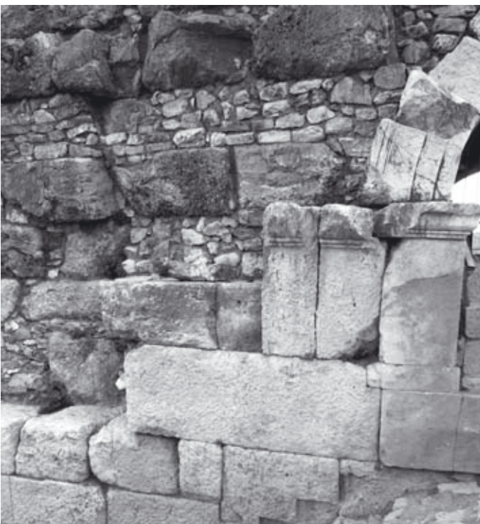
Abb. 805: S-Fassade, erweiterter Gebäudeflügel aus weißen Kalksteinquadern (Frontlage) mit horizontalem Profil. Auskragende Quader des Kernmauerwerks wurden mit »Mauerplomben« aus Bruchstein unterfüttert
